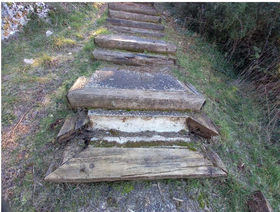
Εικ. 3-4: Φθορά της ξυλείας συγκράτησης του σταθεροποιημένου δαπέδου
