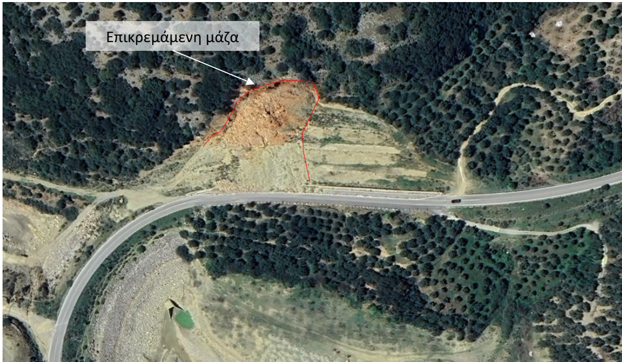
Εικόνα 2.: Περιοχή κατολίσθησης. Στην θέση παρατηρείται μεγάλη κατάρρευση του πρανούς. Τα προϊόντα κατολίσθησης φθάνουν έως τον άξονα της οδού.
